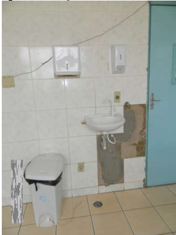
Figura 16- Condições físicas de Paredes
