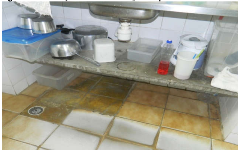
Figura 19- Condições de conservação de pisos
