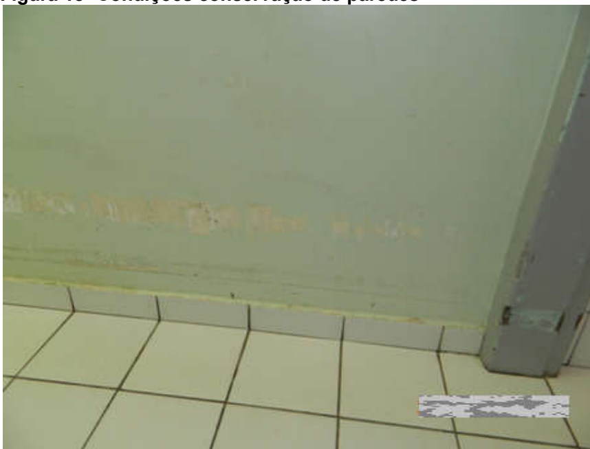
Figura 18- Condições conservação de paredes
