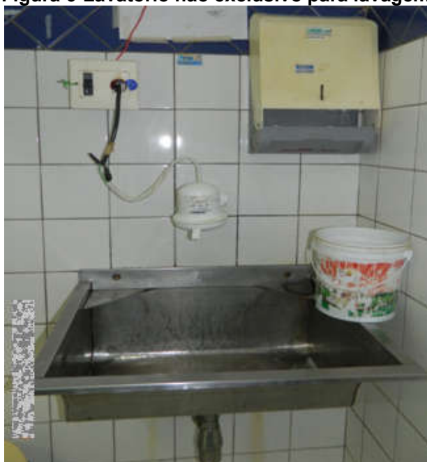
Figura 6-Lavatório não exclusivo para lavagem das mãos
