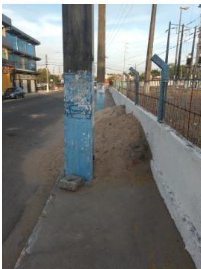
Figura 8 - Calçada com obstrução na Rua 13 de Maio
