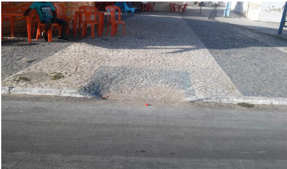
Figura 881: Travessia de pedestres onde não há sinalização tátil direcional e de alerta.
