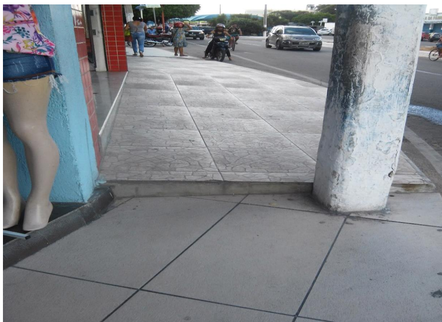
Figura 550: Calçada com mudança de piso e degrau.
