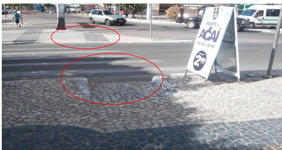
Figura 842: Área de travessia de pedestres onde não há rebaixamento do outro lado.
