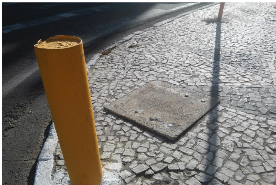
Figura 583: Caixa de inspeção com tampa desnivelada em relação ao piso.
