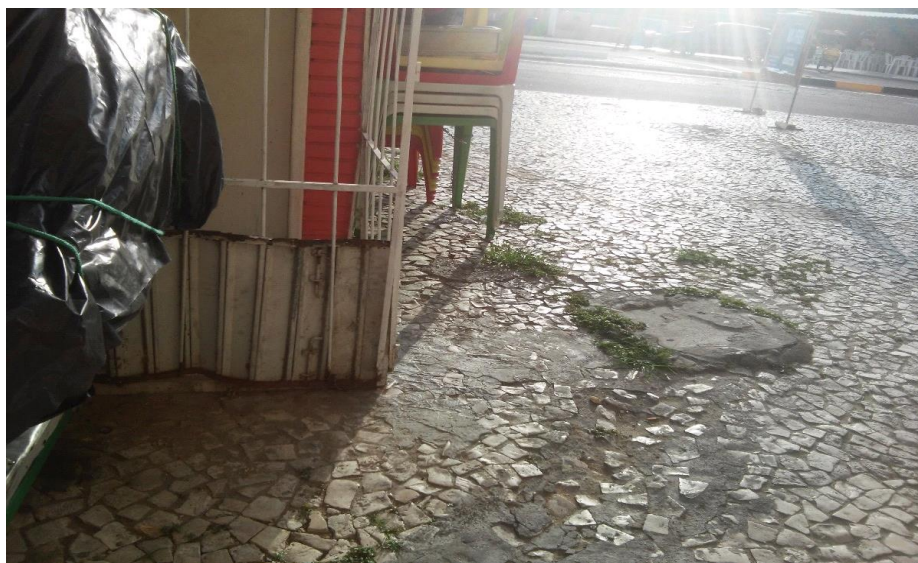
Figura 605: Caixa de inspeção meio da passagem
