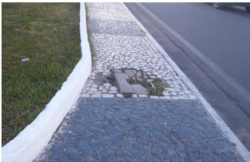
Figura 594: Caixa de inspeção danificada.
