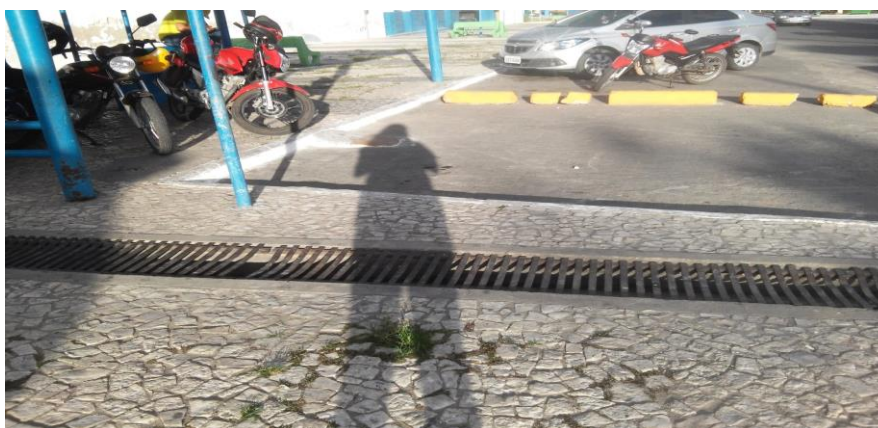
Figura 572: Grelha mal dimensionada.
