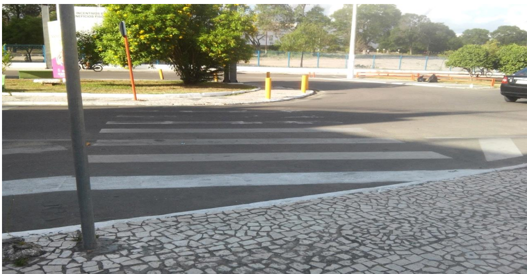
Figura 820: Área sem rebaixamento em ambos os lados das calçadas.
