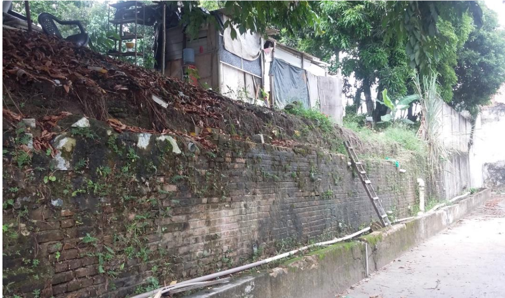
Figura 24: Desmoronamento do muro que separa a escola Padre Cabral do açude
