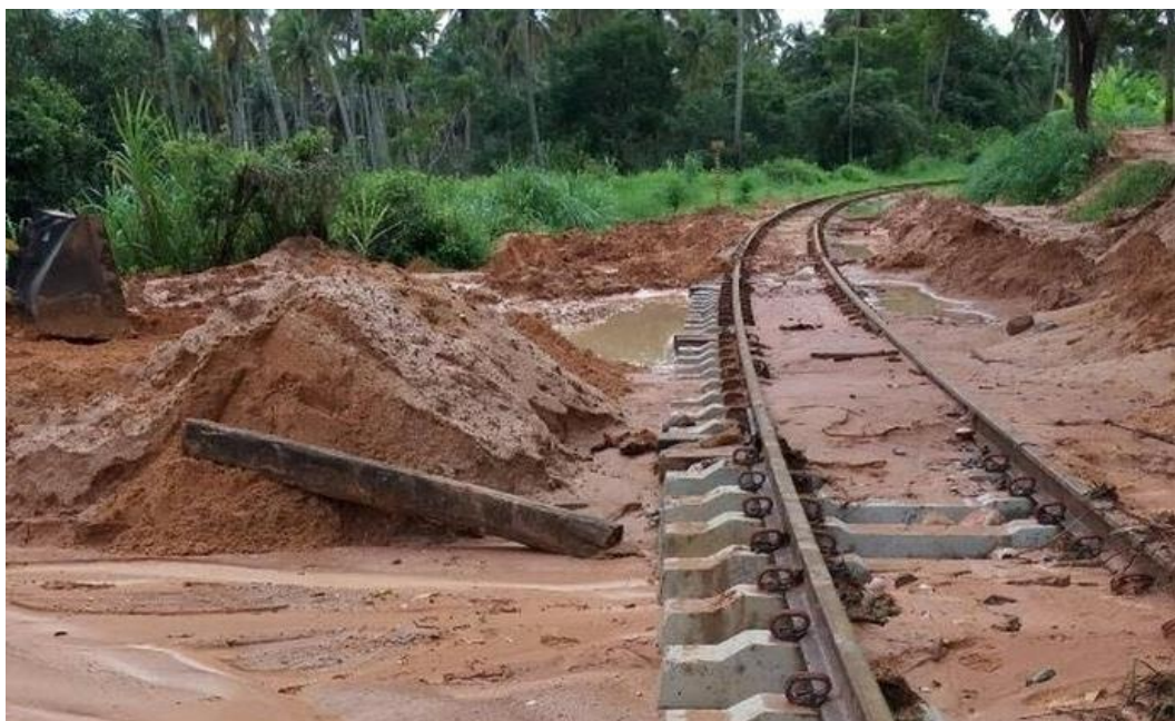
Figura20: Deslizamento de barreira nos trilhos na região de Goiabeira
