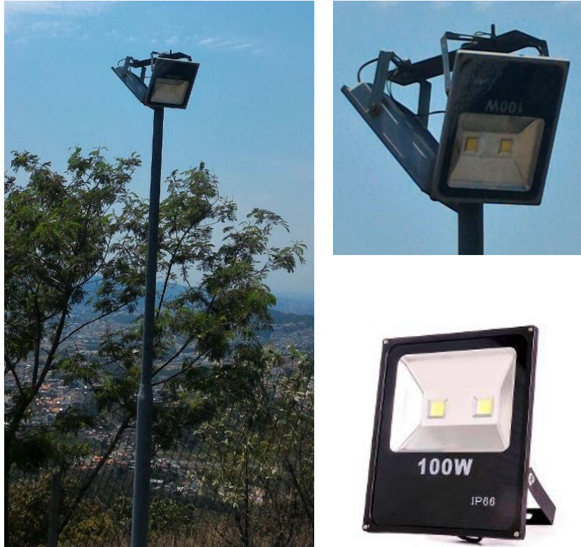
Figura 1.3: Refletores de LEDs usados na iluminação pública.
