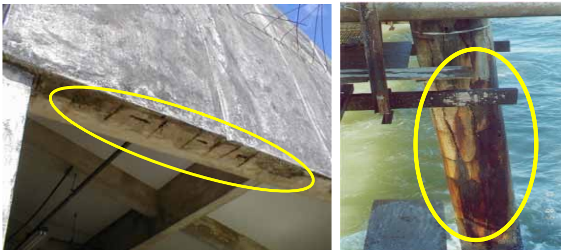
Figura 1.1. Armadura de aço carbono corroída exposta do prédio do CTEC, à esquerda e concreto manchado e fissurado de um pilar do emissário submarino, à direita.
