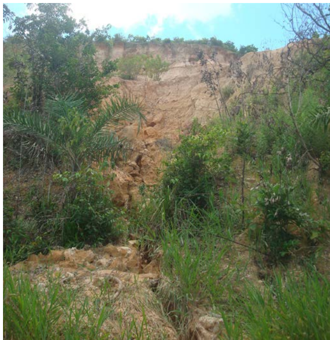
Figura 55 – Voçoroca provocada pela retirada de vegetação nas proximidades do Loteamento do bairro Benedito Bentes
