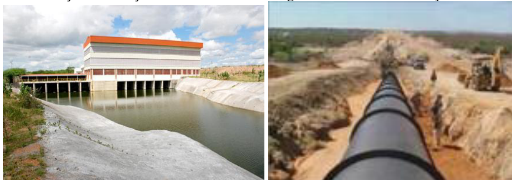
Ilustração 38: Estação elevatória e tomada d'água da estrutura de transição do Canal
