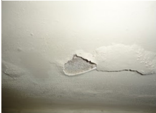
Figura 27 – Destacamento do reboco e da pintura
