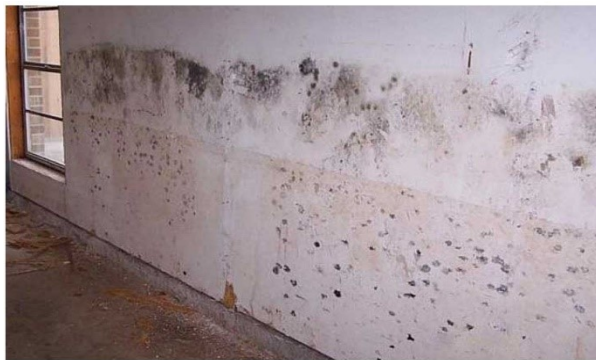
Figura 24 – Manchas causadas por umidade
