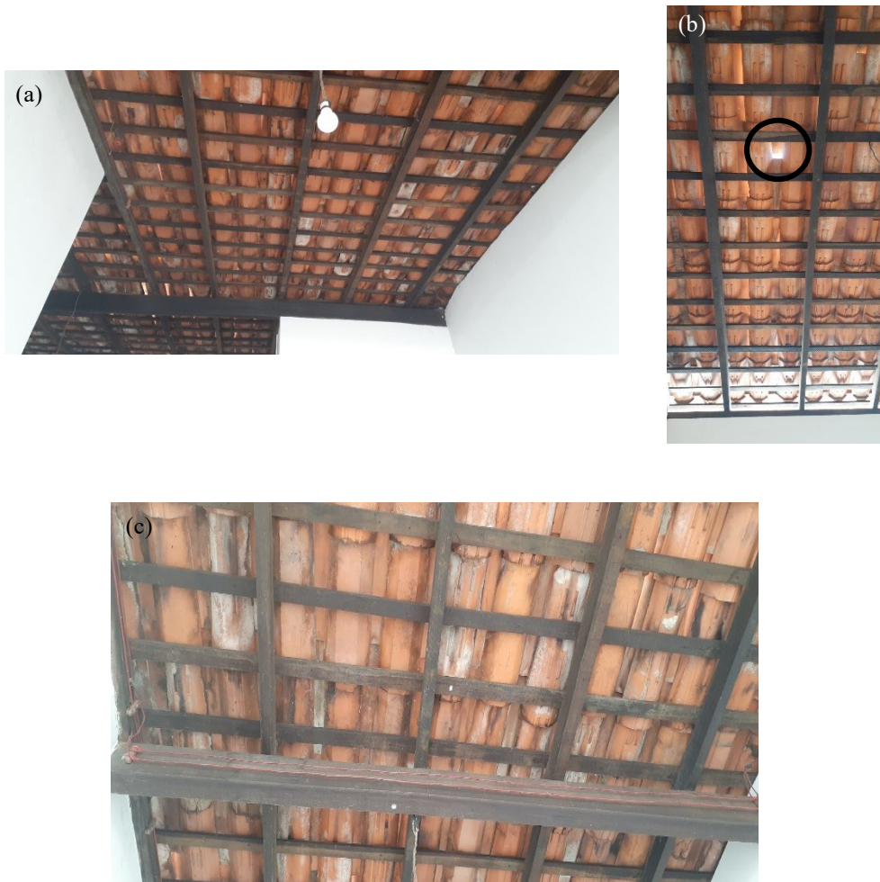
Figura 40 – Problemas na cobertura: (a) sala; (b) quarto 2; (c) cozinha.
