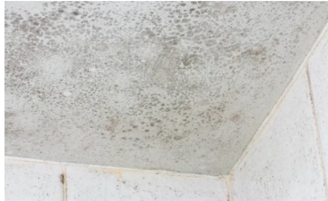
Figura 23 – Umidade provocada por condensação
