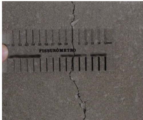
Figura 3 – Trinca em alvenaria (1,0 mm)
