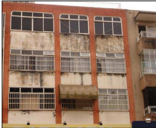
Figura 25 – Bolor em fachada
