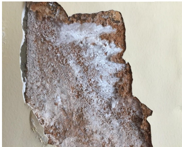
Figura 26 – Eflorescência em alvenaria
