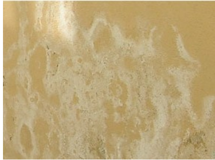
Figura 20 – Eflorescência provocada possivelmente pela umidade de obra
