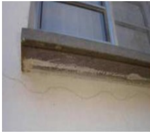
Figura 13 – Fissura horizontal no peitoril da esquadria possivelmente provocada por sobrecarga
