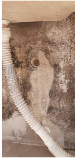
Figura 41 – Problemas nas instalações hidrossanitárias
