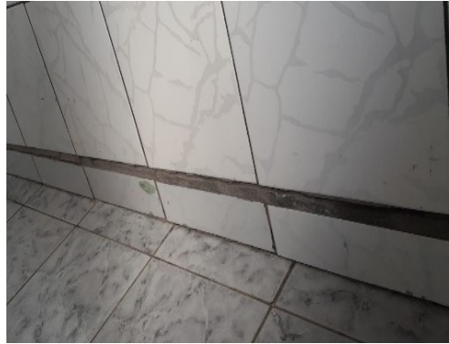
Figura 35 – Ineficiência do rejunte na parede da cozinha
