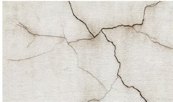
Figura 17 – Fissuras na argamassa de revestimento
