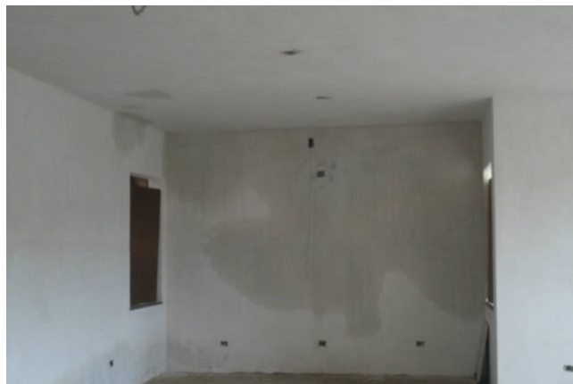
Figura 22 – Umidade provocada pela água da chuva ou por vazamentos de redes hidráulicas
