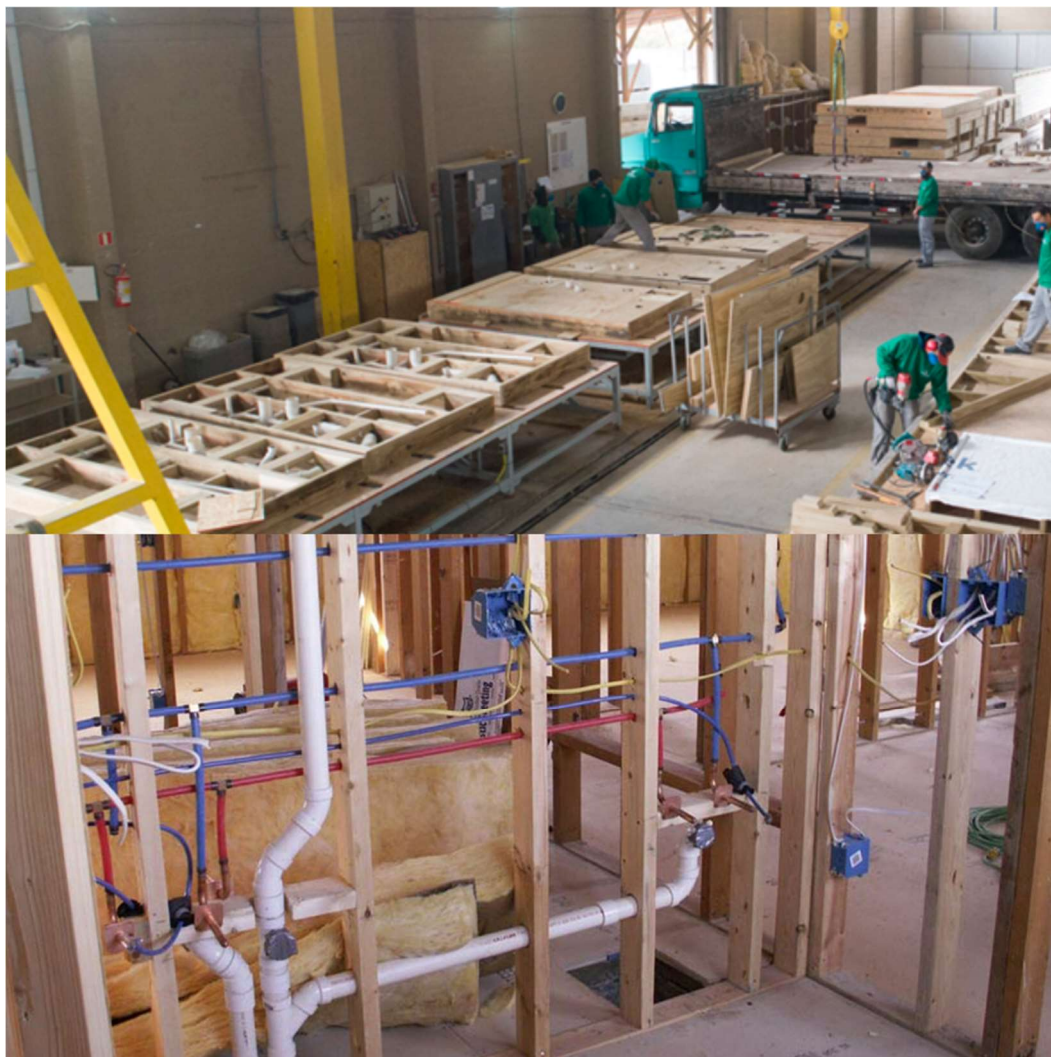
Figura 39 – Instalações no sistema construtivo Wood Frame
