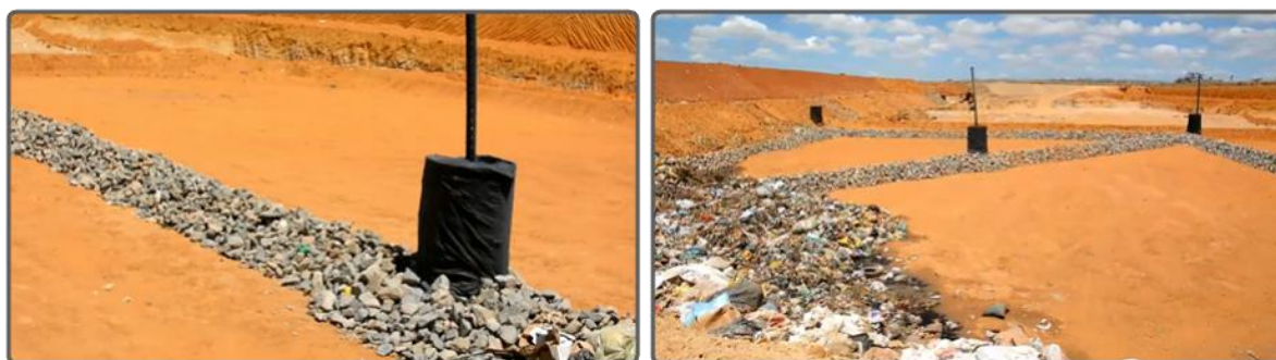
Figura 14 - Drenagem de chorume e de gases do aterro sanitário do Agreste.
