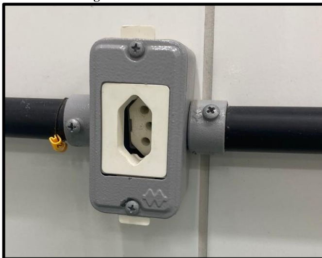
Figura 7 - Tomada com defeito
