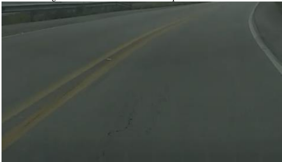
Figura 42 - Trinca isolada entre os quilômetros 95 e 96
