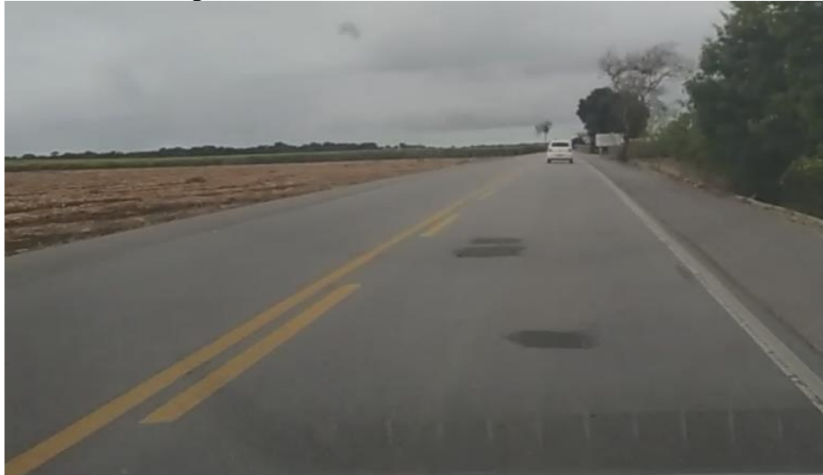
Figura 43 - Remendo no Km 93 no lado direito
