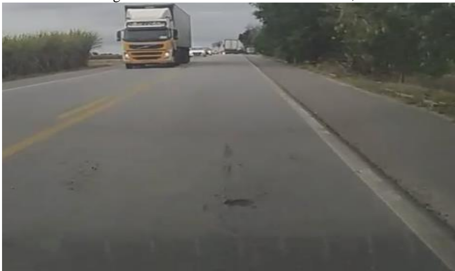
Figura 40 - Buraco com trincas no Km 92,7
