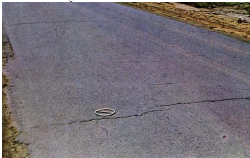
Figura 08 - Trinca isolada transversal
