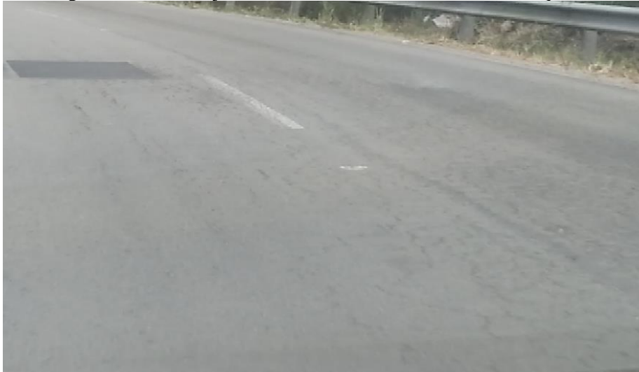
Figura 37 - Trincas jacaré e remendo no Km 105 no lado esquerdo
