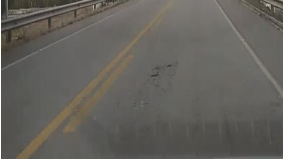
Figura 39 - Trincas jacaré com buracos no Km 92,1
