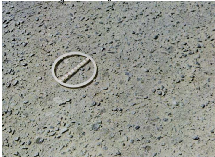
Figura 15 - Desgaste em rodovia
