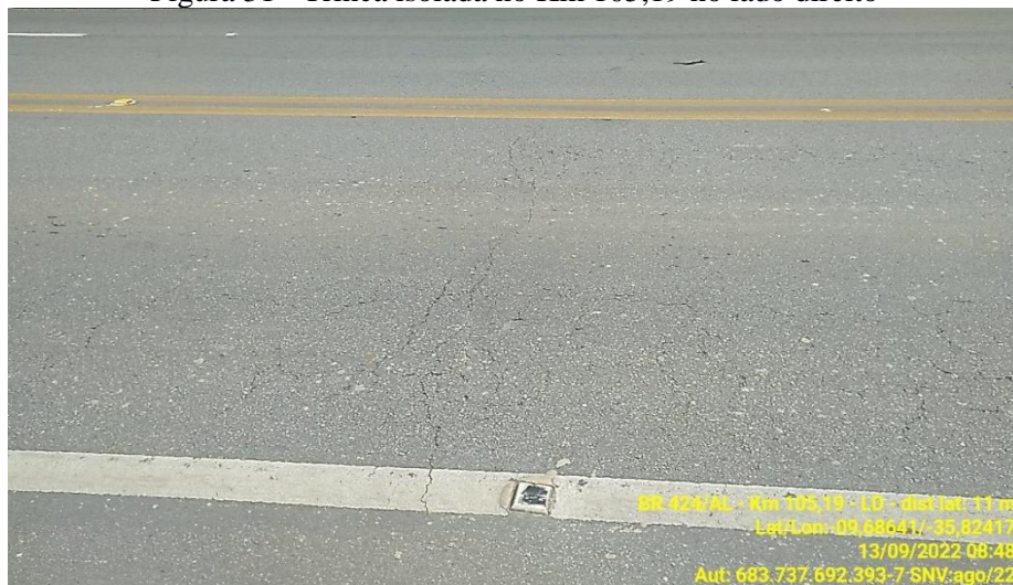
Figura 31 - Trinca isolada no Km 105,19 no lado direito
