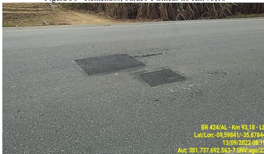
Figura 36 - Remendos, buraco e trincas no Km 93,18
