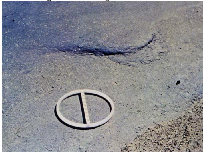
Figura 17 - Escorregamento de massa
