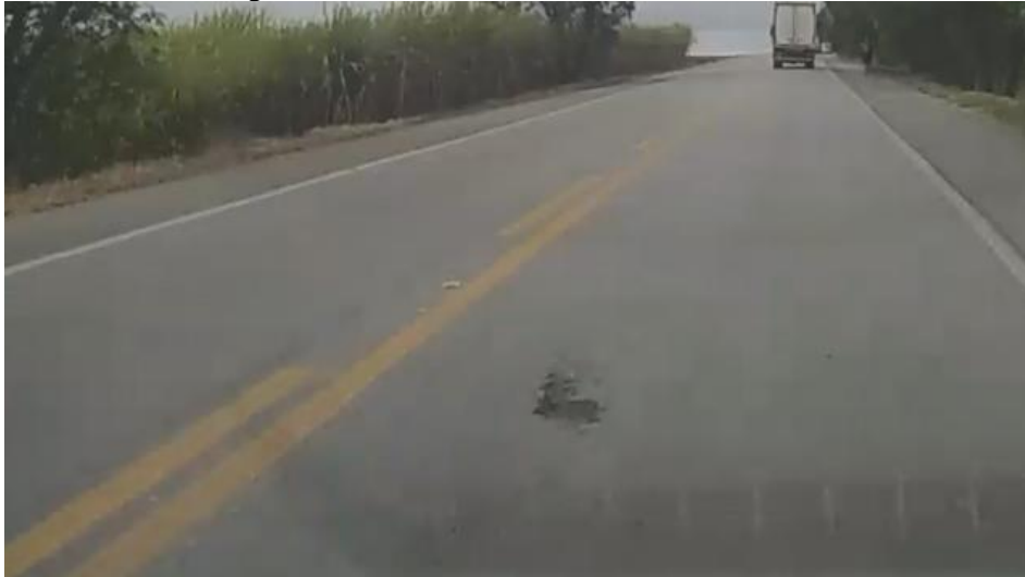
Figura 41 - Buraco no Km 92,4 no lado direito
