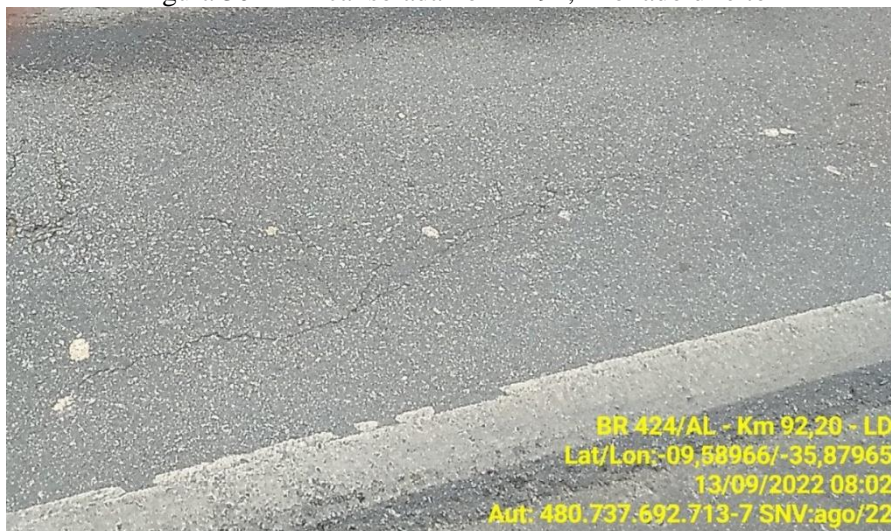
Figura 30 - Trinca isolada no Km 92,2 no lado direito
