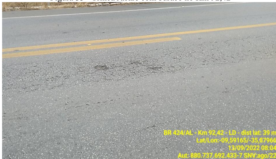
Figura 33 - Trinca Jacaré com buraco no Km 92,42
