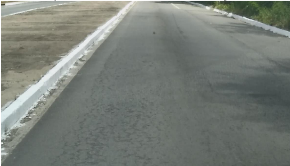
Figura 38 - Trinca Jacaré no Km 104 no lado esquerdo
