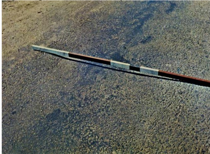
Figura 12 - Afundamento plástico localizado
