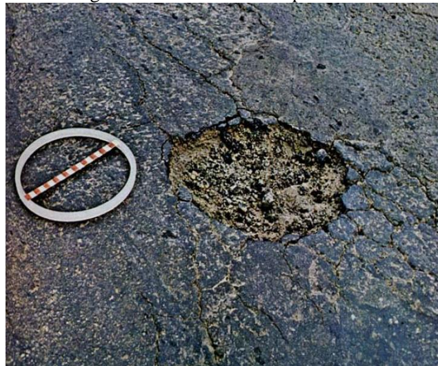
Figura 06 - Buraco em um pavimento
