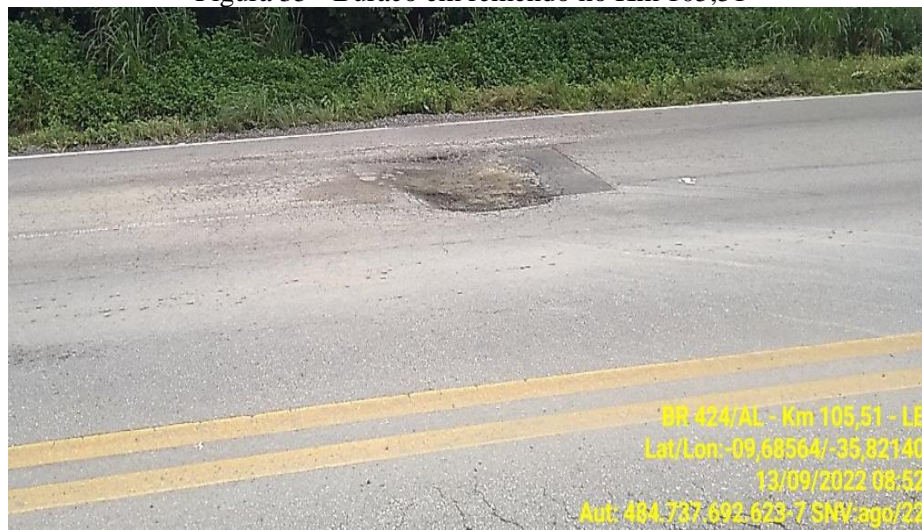
Figura 35 - Buraco em remendo no Km 105,51
