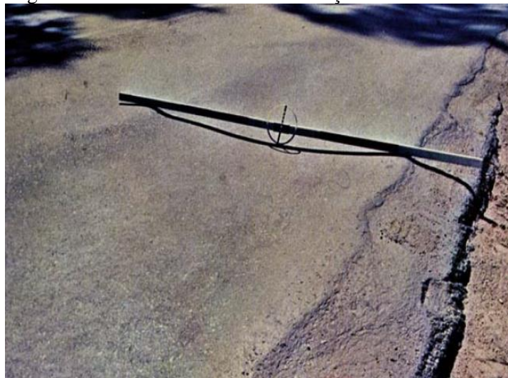
Figura 13 - Afundamento de consolidação em trilha de roda
