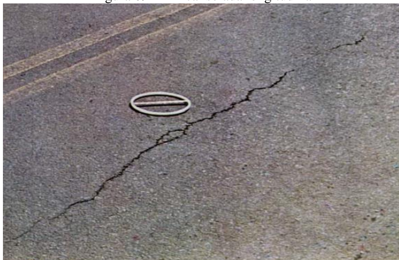
Figura 09 - Trinca isolada longitudinal
