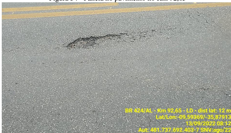
Figura 34 - Panela no pavimento no Km 92,65
