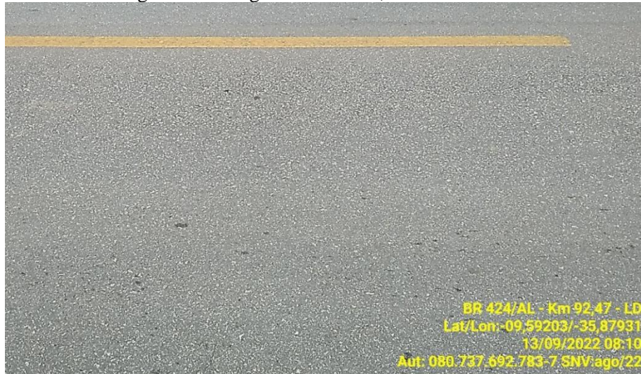
Figura 29 - Desgaste no Km 92,47 no lado direito
