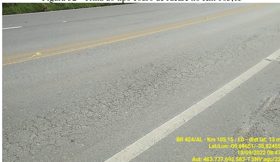
Figura 32 - Trina do tipo couro de Jacaré no Km 105,15
