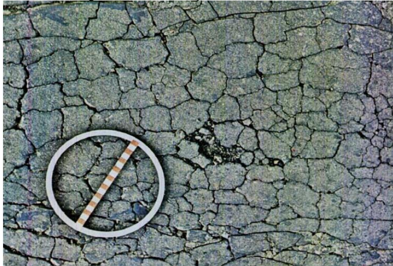
Figura 10 - Trinca tipo “Couro de Jacaré”
