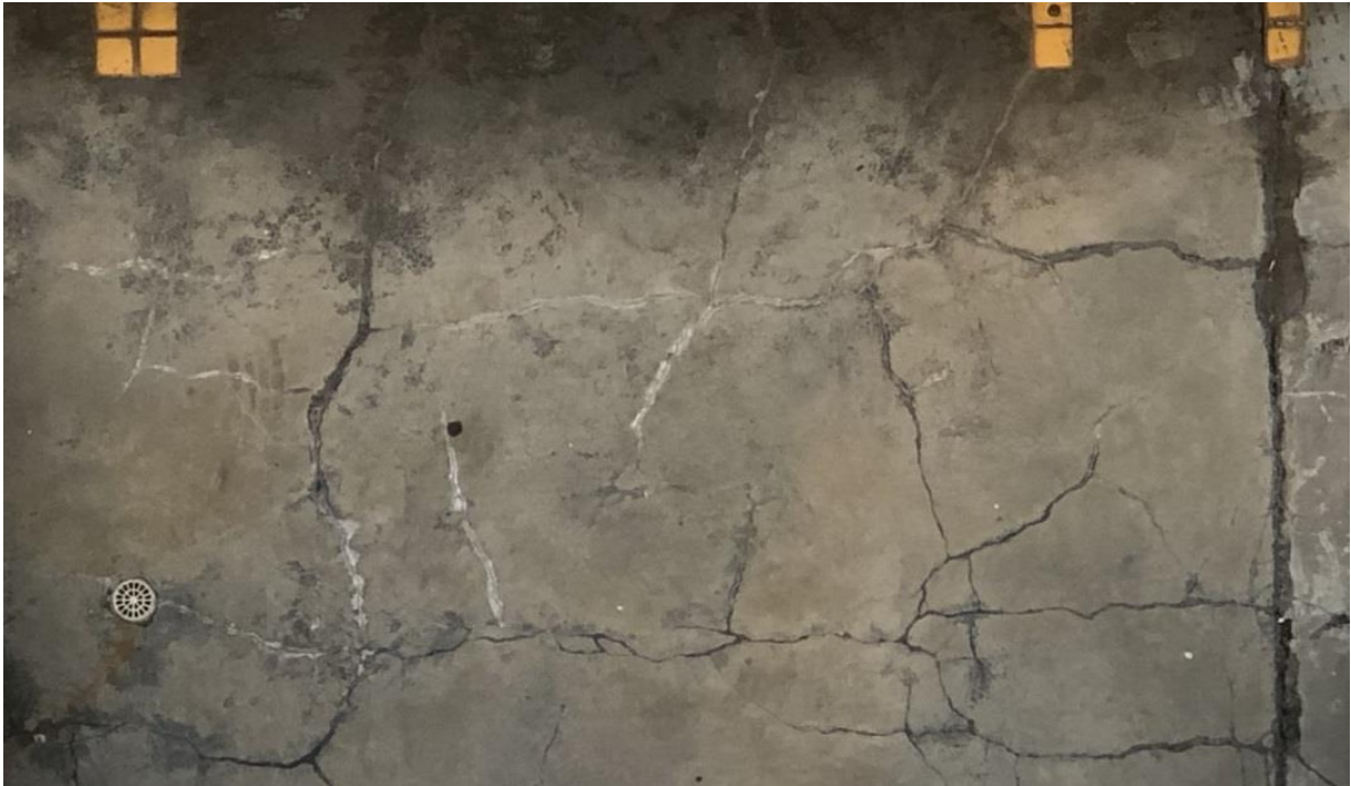
Figura 3 - Aparecimento de fissuras em uma laje devido à retração.
