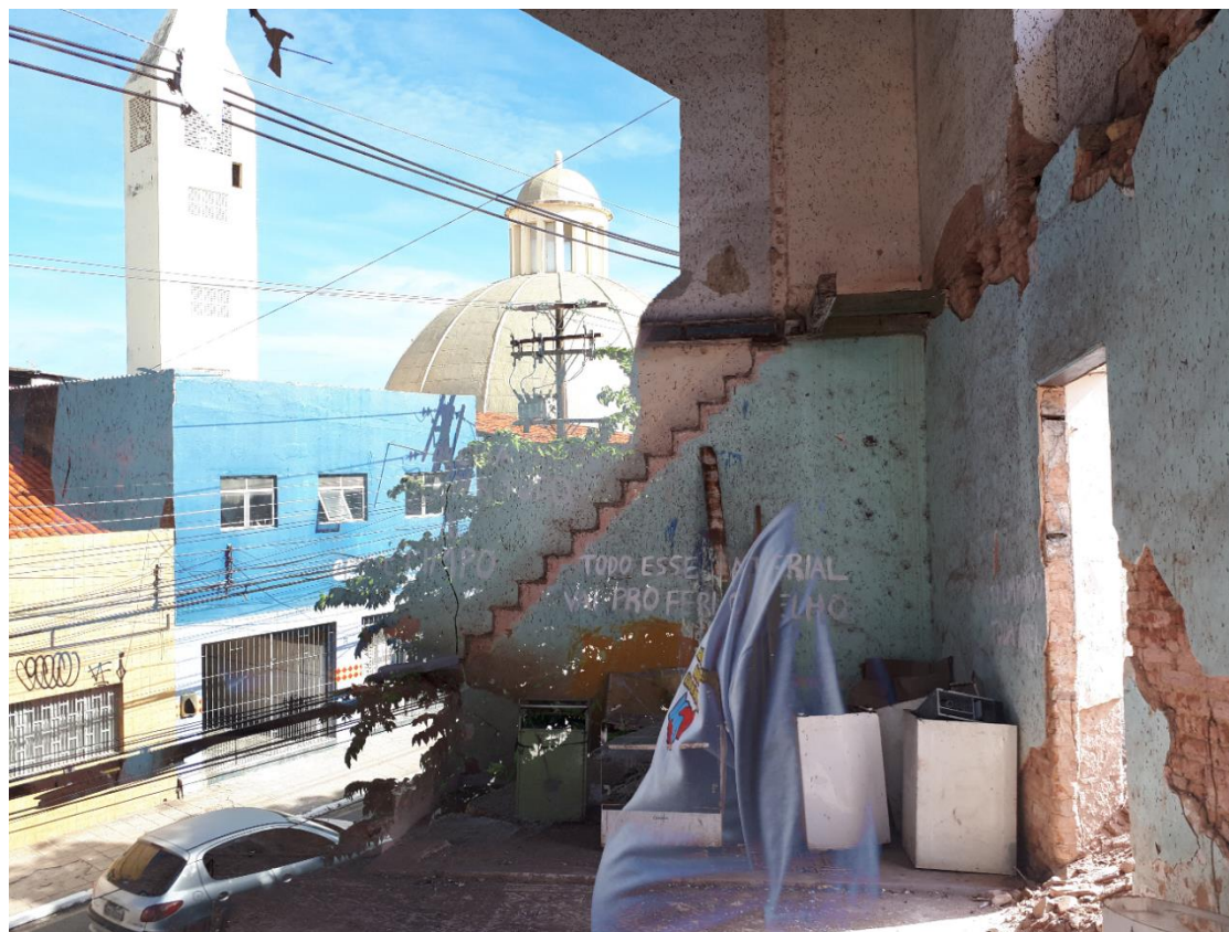
Figura 28: Fotomontagem antiga Cine Plaza, ruínas em seu interior e vista para a cúpula. Produzido pela autora, 2019.
