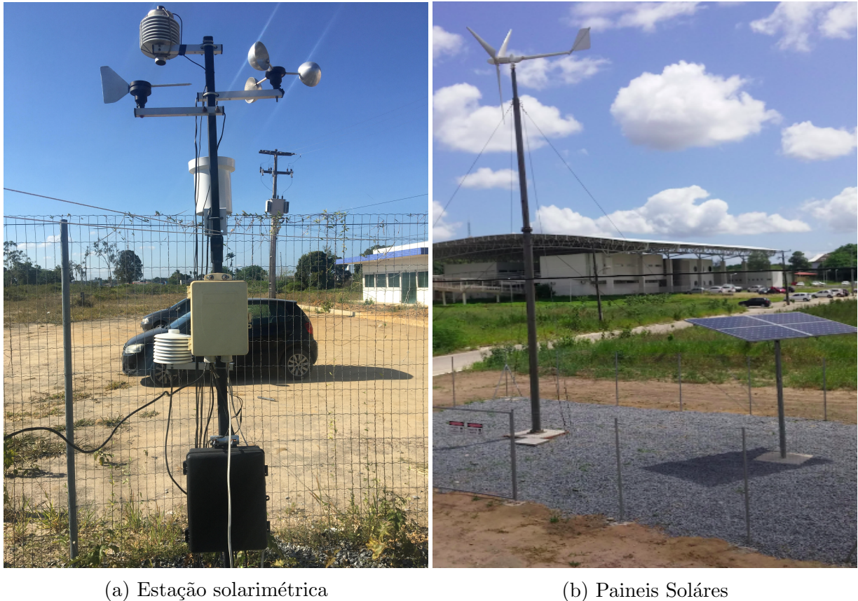
Figura 3.1: Fotos da estação solarimétrica e dos painéis solares instalados na UFAL.
