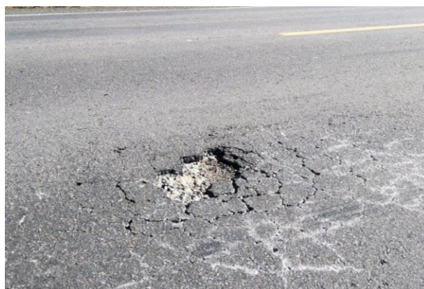
Figura 13 - Painela causada por trincas por fadiga
