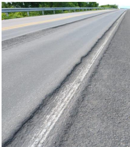
Figura 14 - Afundamento de trilha de roda
